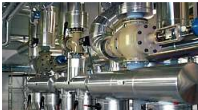
Un impianto di teleriscaldamento
